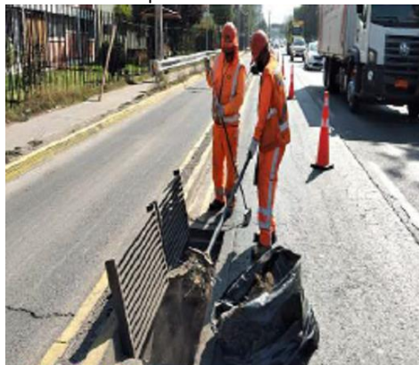
Limpieza de Sumideros
